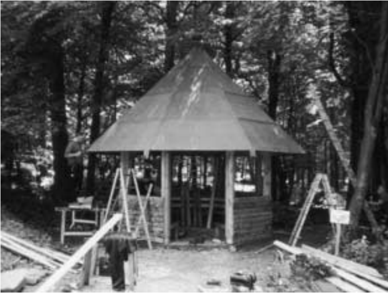
OG Bad Münstereifel. Mit vereinten Kräften wurde in kürzester Zeit eine neue Schutzhütte im Münstereifeler Wald nahe der Waldkapelle „Decke Tönnies“ errichtet.
