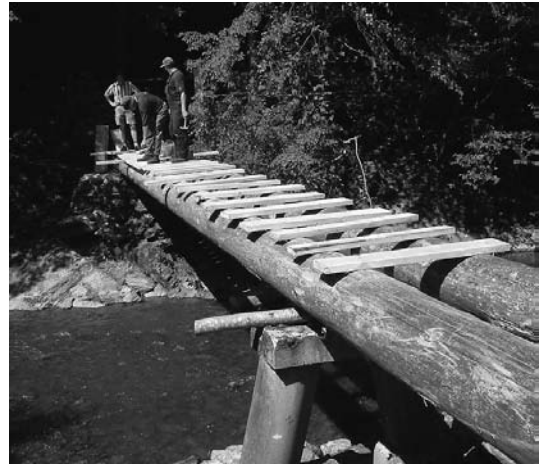
OG Manderscheid. Die Männer vom Forstrevier Manderscheid erneuern die Lieserbrücke am Burgweiher.
