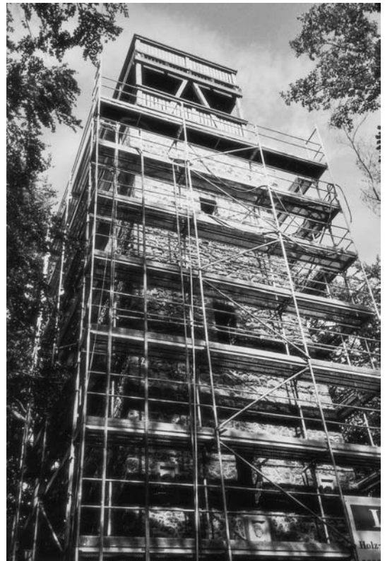
OG Brohltal. Erst nach der Einrüstung konnte man das tatsächliche Ausmaß der Schäden am Gemäuer erkennen. © H. Wellershaus
