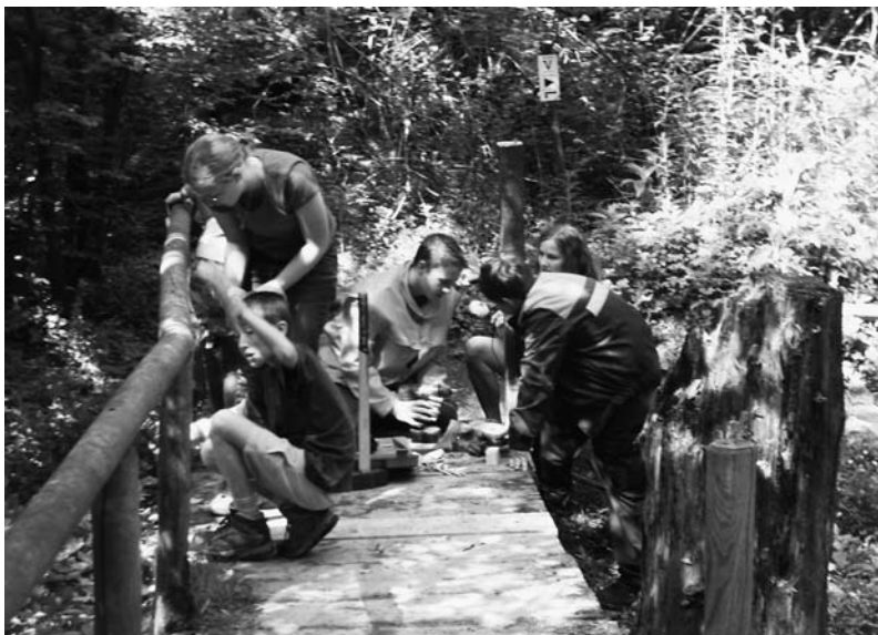
OG Daun. Kräftig zupacken mussten die Jugendlichen des Dauner Eifelvereins, um die marode Winkelbachbrücke entlang des Lieserpfades zu sanieren. © W. Balzert
