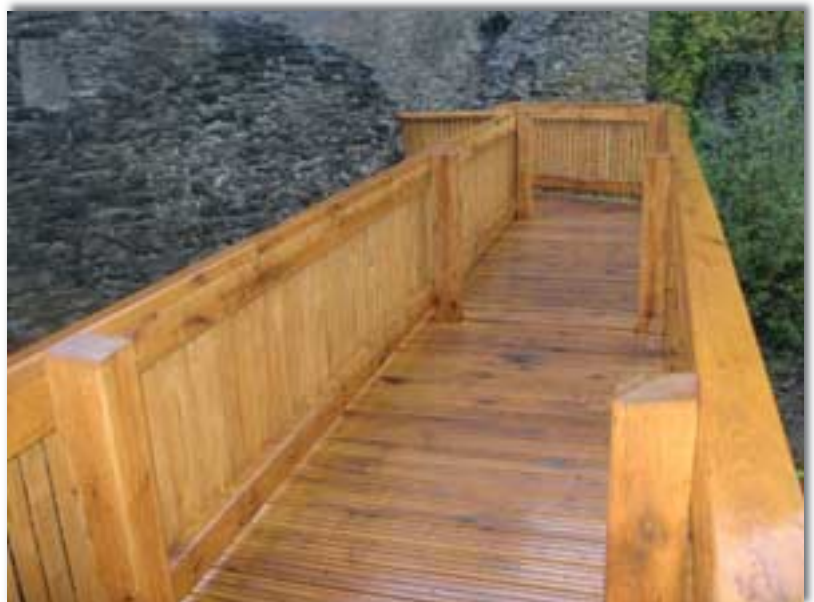
Abb. 9: Die Sanierung der Brücke zum Ostturm war zur Gewährleistung der Verkehrssicherungspflicht erforderlich und stellt zugleich eine attraktivitätssteigernde Maßnahme dar.
