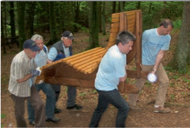
OG Gerolstein. Kräftiges Anpacken war gefragt bei der Renovierung der Wegemöblierung. Foto: OG Gerolstein
