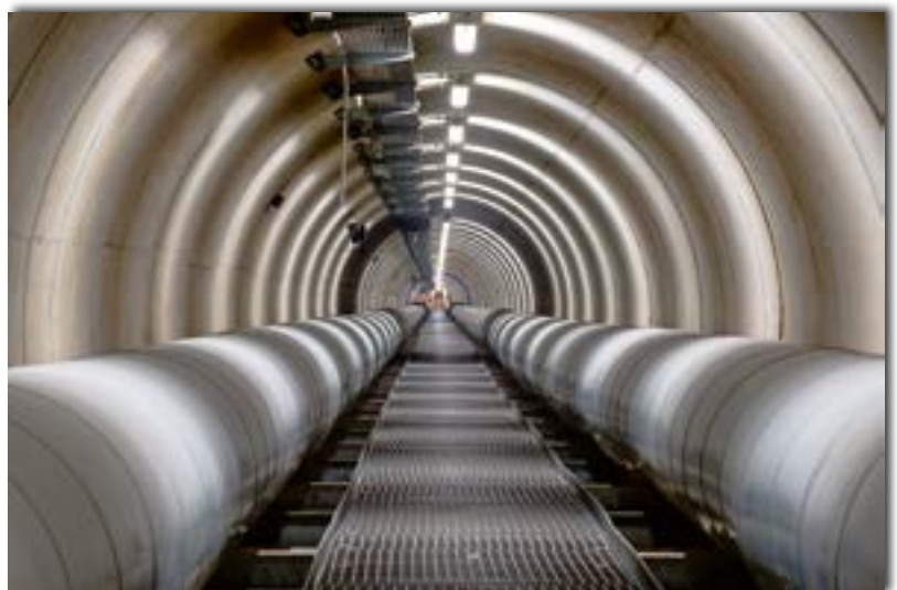
Köln. Einmal unter dem Rhein spazieren gehen? Der Fernwärmehunnel der Rhein-Energie macht's möglich. Foto: RheinEnergie AG
