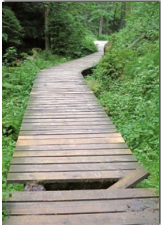
Eine gebrochene Holzbohle als Stolperfalle. Wer haftet?
