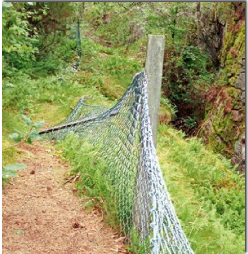
Wer eine Absperrung baut, muss dafür sorgen, dass sie stets in Ordnung ist. Foto: Reinhard Wolf
