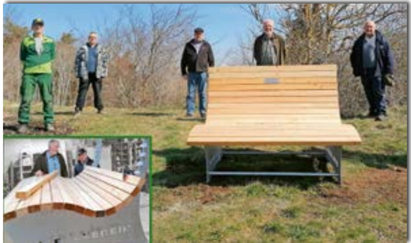
OG Lissendorf-Birgel. Hier lässt es sich gut entspannen. Bild im Bild: Peter Klein und Günter Klinkhammer bei der Montage Foto: Ulrich Berger
