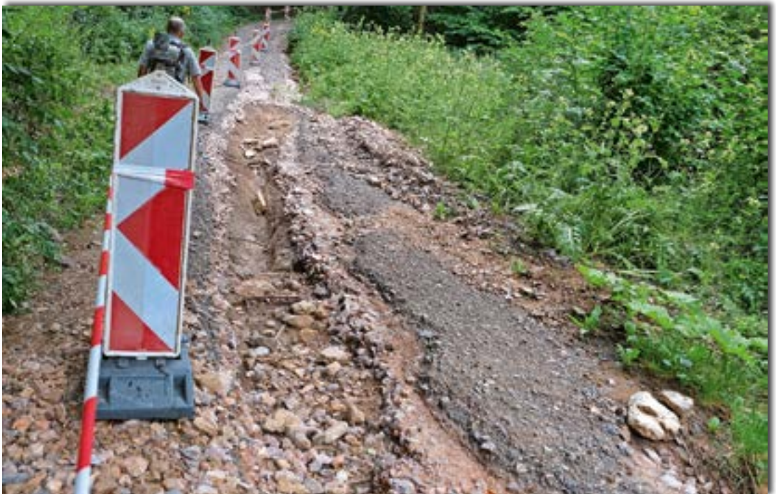
Ausgespülter Eifelsteig bei Zingsheim
