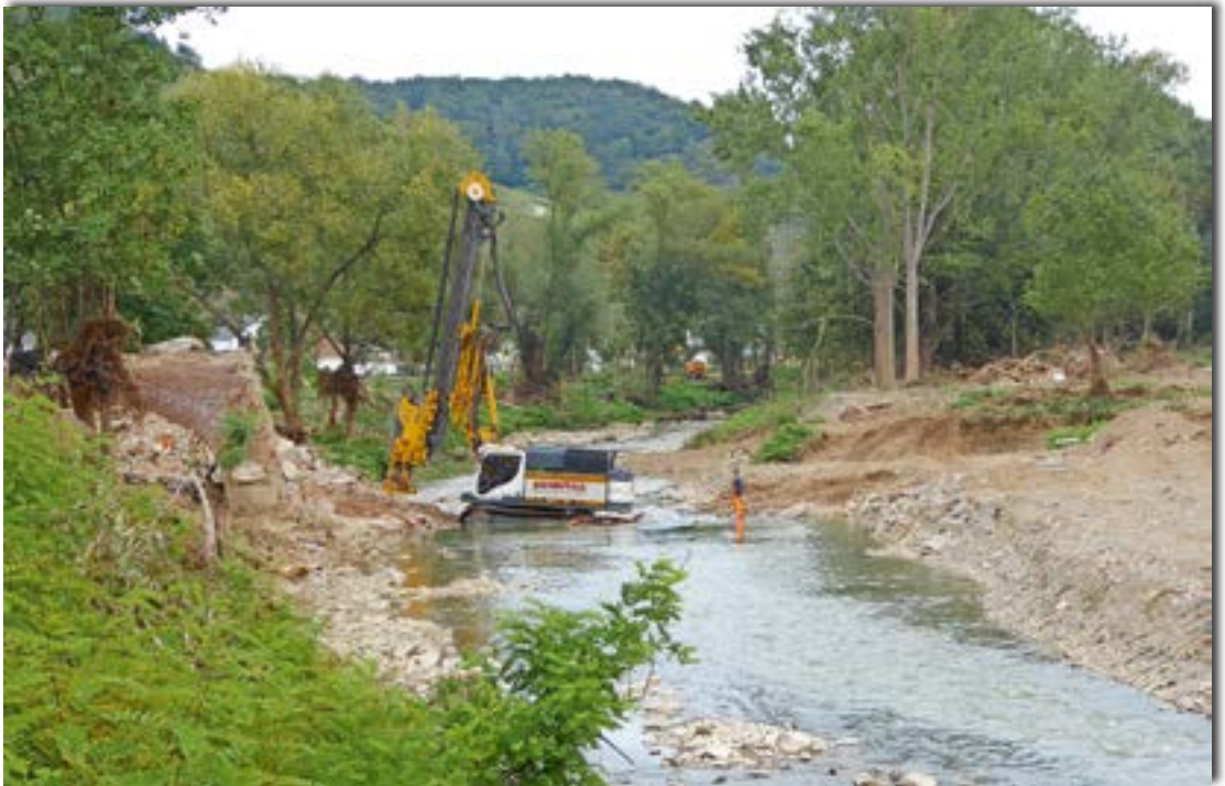
Links des Baggers steht noch ein Stumpf der Brücke in Bad Neuenahr-Ahrweiler, über die der Osteifelweg führte.
