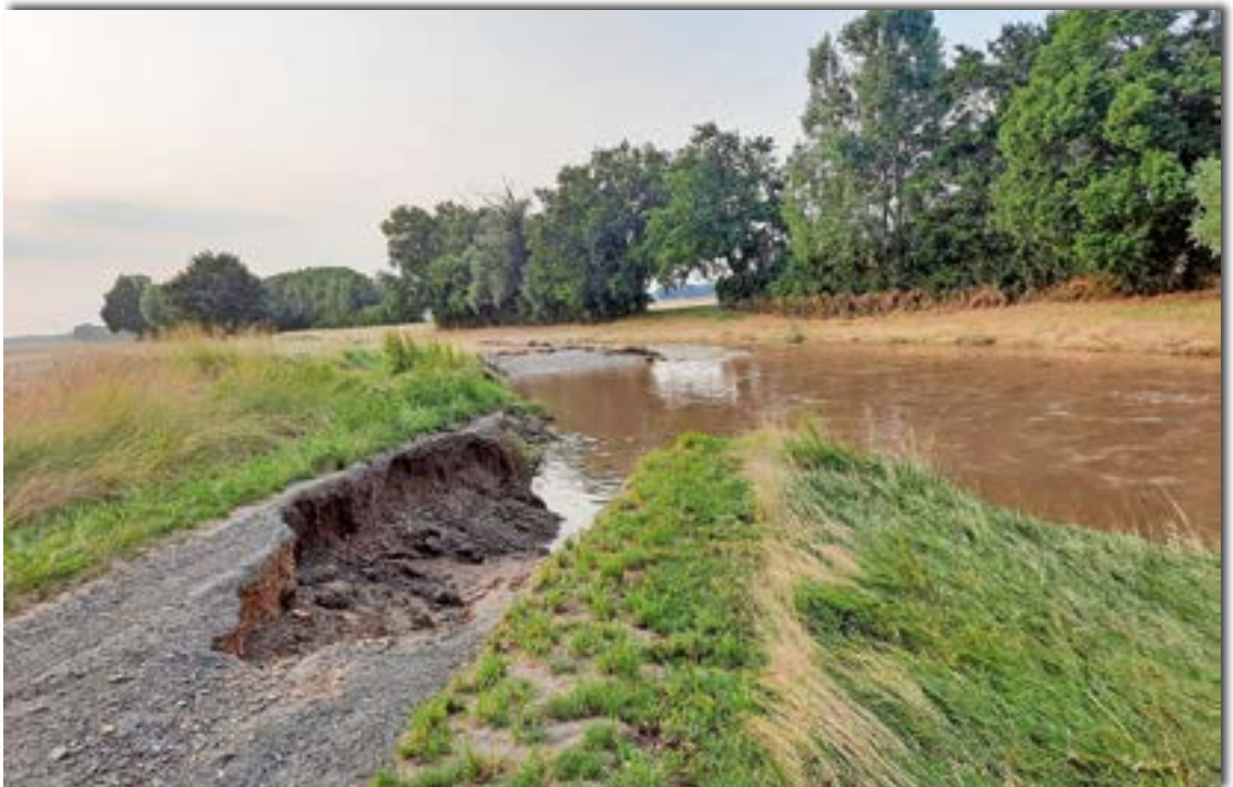
Wanderweg Nr. 5: Erft Bliesheim Richtung Liblar komplett weggerissen
